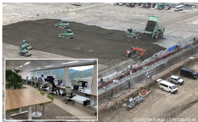
稼働中のA 4 CSEL (@CSGダム2020年～)
